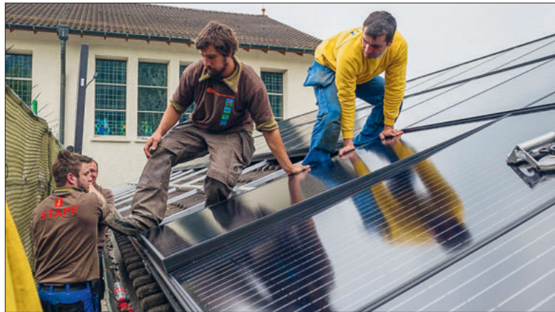
2013 entstand die Solaranlage auf dem Pfarrsaal mit Jungwacht, Blauring und BE-Netz AG. Foto: Pfarrei Littau
